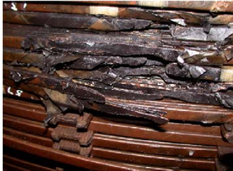
Daño en el transformador
